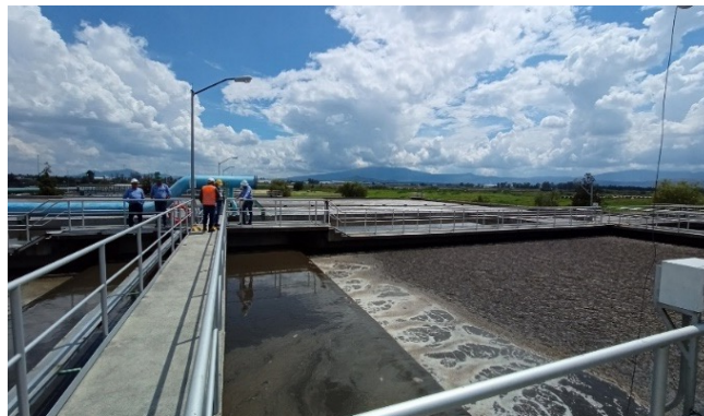
Descargas de aguas residuales.
