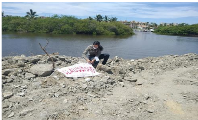
Clausura de obras a orillas del estero Nuevo Vallarta, Nayarit
