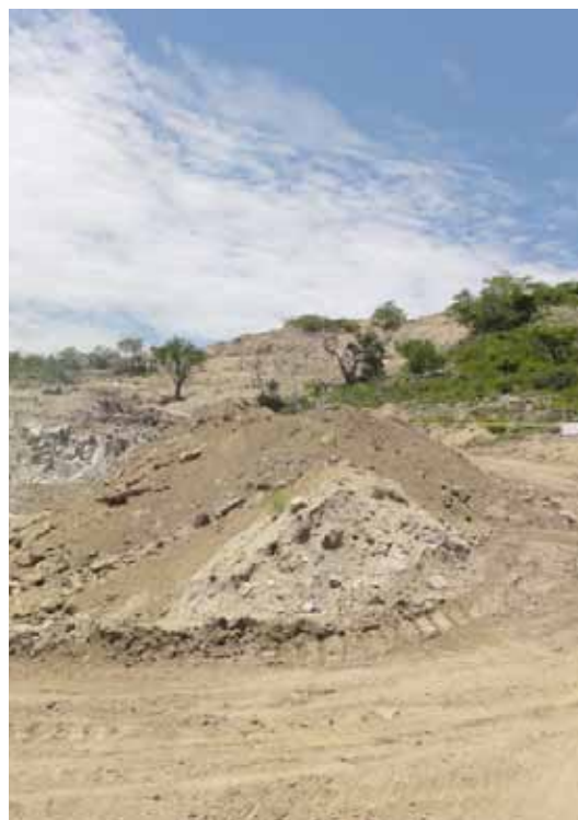
Clausura por extracción de materiales pétreos
