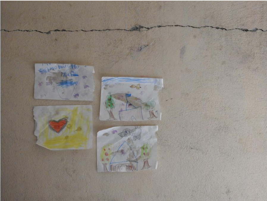
Afectaciones en casas de algunas comunidades del Municipio Los Ramones, N. L.
