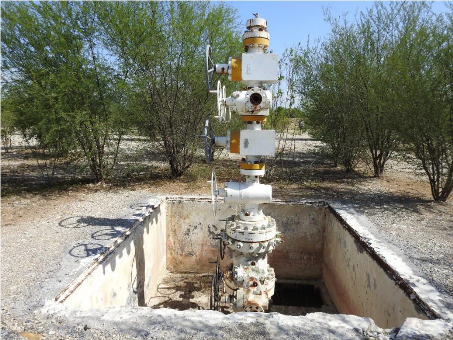
VALVULAS Instaladas en la perforación del pozo Tangram-1. Municipio Los Ramones, N. L.
